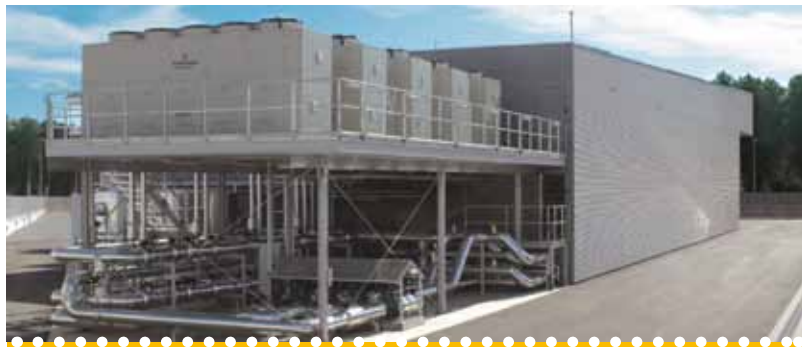
Il data center di T-Systems a Barcellona
